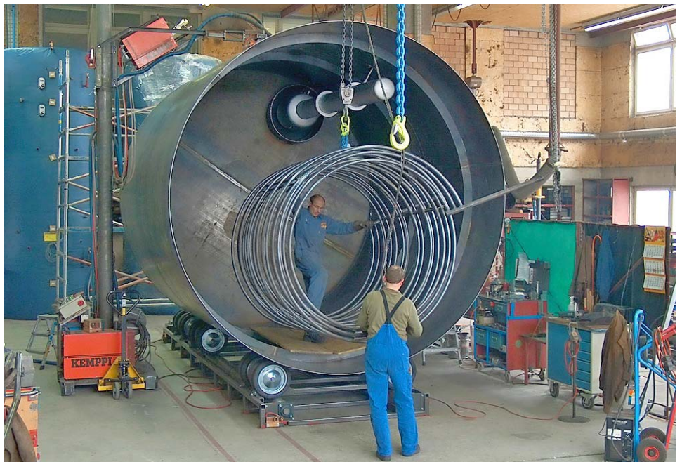
Der Swiss Solartank bietet Volumen bis über 200 000 Liter und dient mit eingebauten Wärmetauschern und Warmwasserboiler der ganzjährigen Wärmeversorgung. (Foto: Jenni Energietechnik AG)
