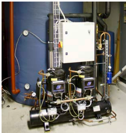
Die Wärmepumpe wurde vor dem Speichertank montiert. (Bild: Jenni Energietechnik AG)
