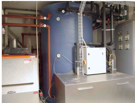
Im Mittelpunkt des neuen Systems zur Abwärmerückgewinnung steht ein Speichertank der Jenni Energietechnik AG. (Bild: Jürg Wellstein)
