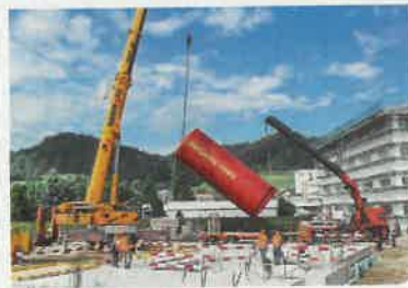
► Zanim rozpocznie się wznoszenie ścian, na płycie fundamentowej ustawia się zbiornik akumulacyjny
