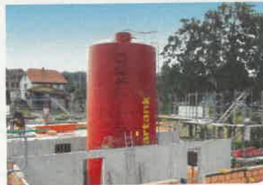
► Zbiornik akumulacyjny jest zlokalizowany w wydzielonej części wspólnej, przy klatce schodowej. W tej części budynku wzniesiono żelbetowe ściany wewnętrzne. Pozostałe wymurowano z ceramiki
