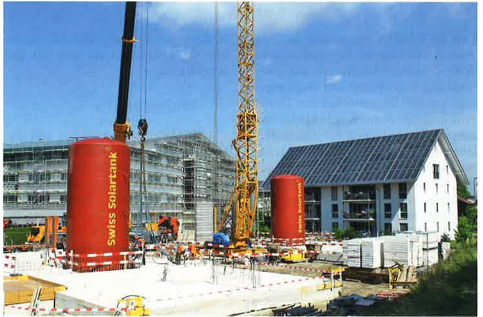
Die solar gewonnene Wärme wird in riesigen Tanks gespeichert.
