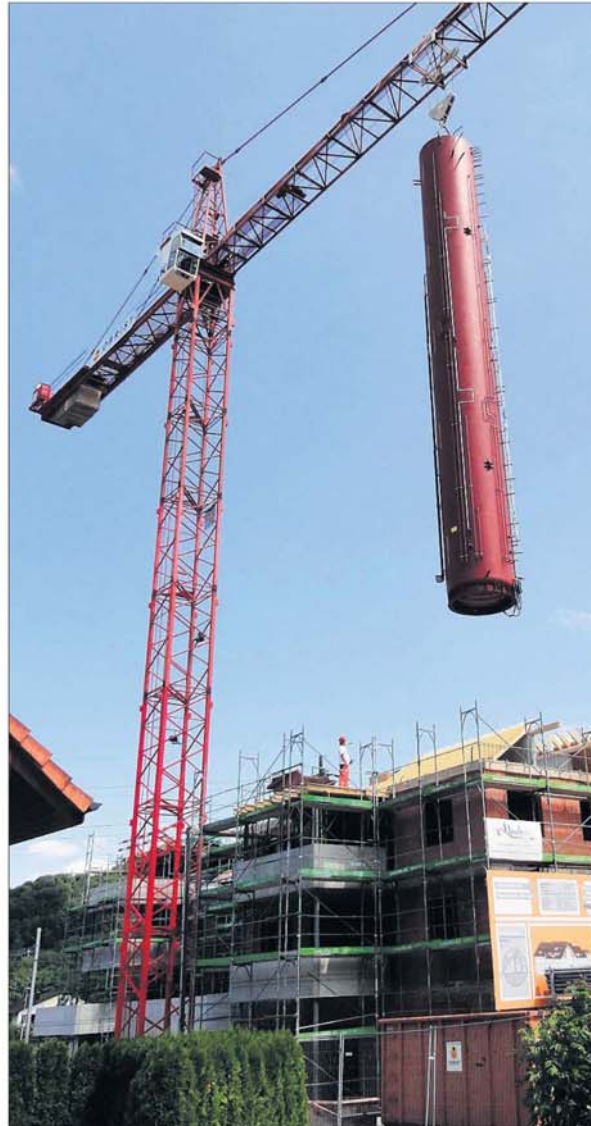
18 METER HOCH UND 7 TONNEN SCHWER Solartank wird vom Baukran ins Treppenhaus der Überbauung Zentrum in Eiken gehievt. CHR
