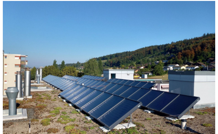
100 m 2 Solarthermieanlage auf Mehrfamilienhaus
