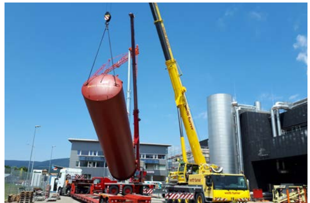
2x 120 000 Liter, Abwärmenutzung, Ricola, Laufen
