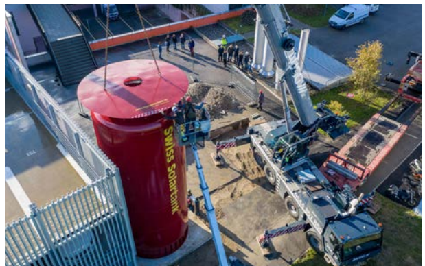
100 000 Liter, Hackschnitzel + Gas, Wärmeverbund Burgdorf Süd
