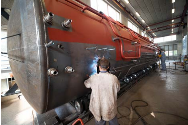
89 000 Liter, Solarthermie + Holz, Wohnüberbauung Mettmenstetten
