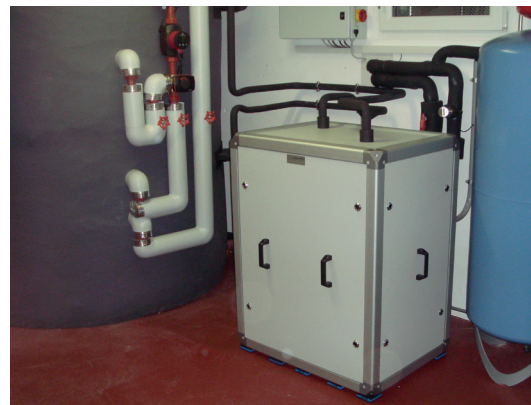
Sole-Wärmepumpe unmittelbar neben Swiss Solartank
