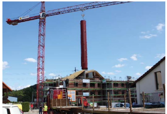
Mehrfamilienhaus, Eiken (Montage 55'000 | Solarspeicher)
