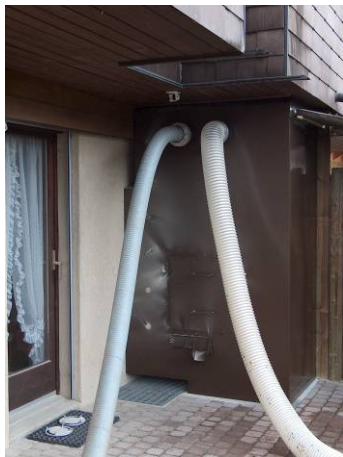
Förderung und Luftabsaugung durch Schläuche
