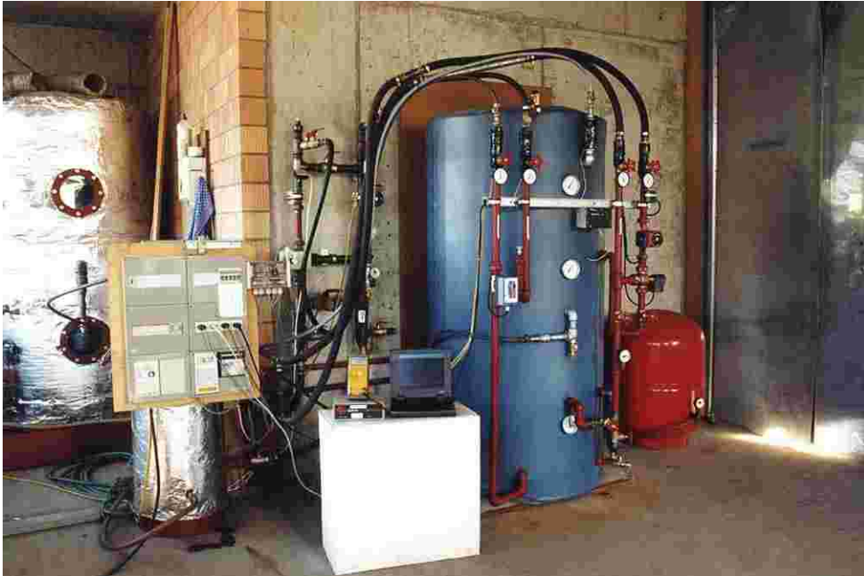
Im Labor wird eine Fernheizungs-Hausstation ausgemessen und optimiert.
