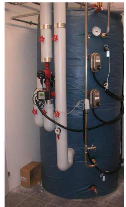
Der gedämmte Jenni-Speicher in einer Migrolino-Tankstelle.
