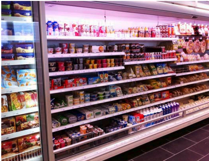
Kühlmöbel in einem Migrolino-Tankstellenshop.
